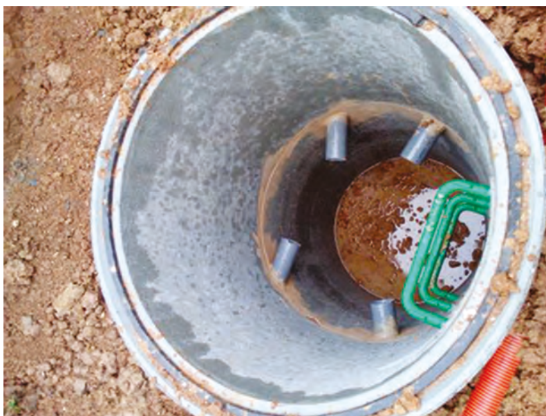
Regard béton permettant l'échantillonnage des eaux infiltrées (© Adopta)
